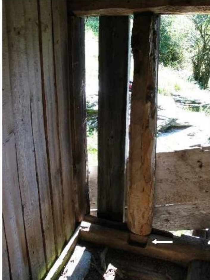
Ill. 13 : Echancrure faite au pied d'une paroi de séparation dans le seuil de la porte d'une grange-écurie et témoignant de la petitesse de la partie du bâtiment possédée
